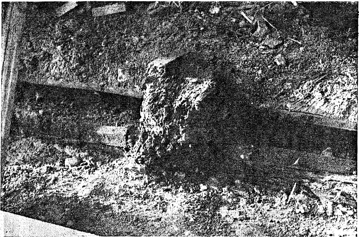
Billedet viser resterne af et bjælkehoved under stolpevæggen, ødelagt af råd som følge af fugtighedens nedsvivning.
